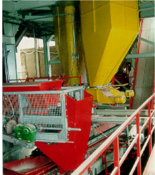
Bild 1: Silos für Pulverpigmente mit steilem Auslauftrichter (im Einsatz mit Granulaten)
